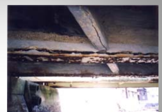
補修・補強箇所の新劣化
