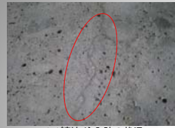
ひび割れ注入跡の状況
