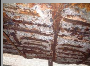
主桁下面の鉄筋腐食
