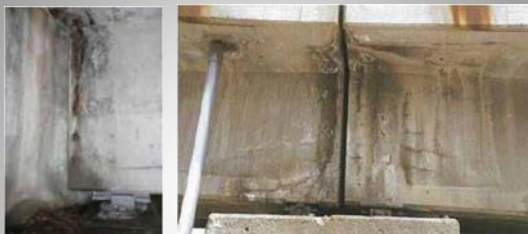
桁端部で局部的に発生した塩害(凍結防止剤による塩害)
