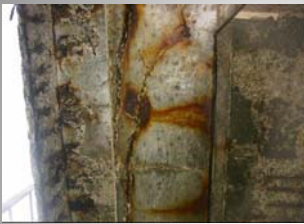
床版下面の錆汁
