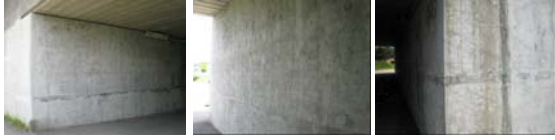
S橋橋台 施工前状況と施工後6年経過時の状況
